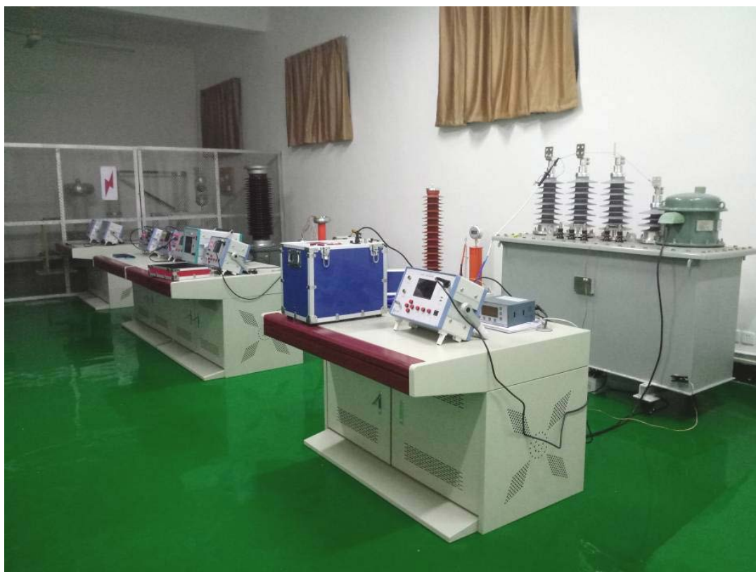
图 23 高压电气试验仿真实训室
