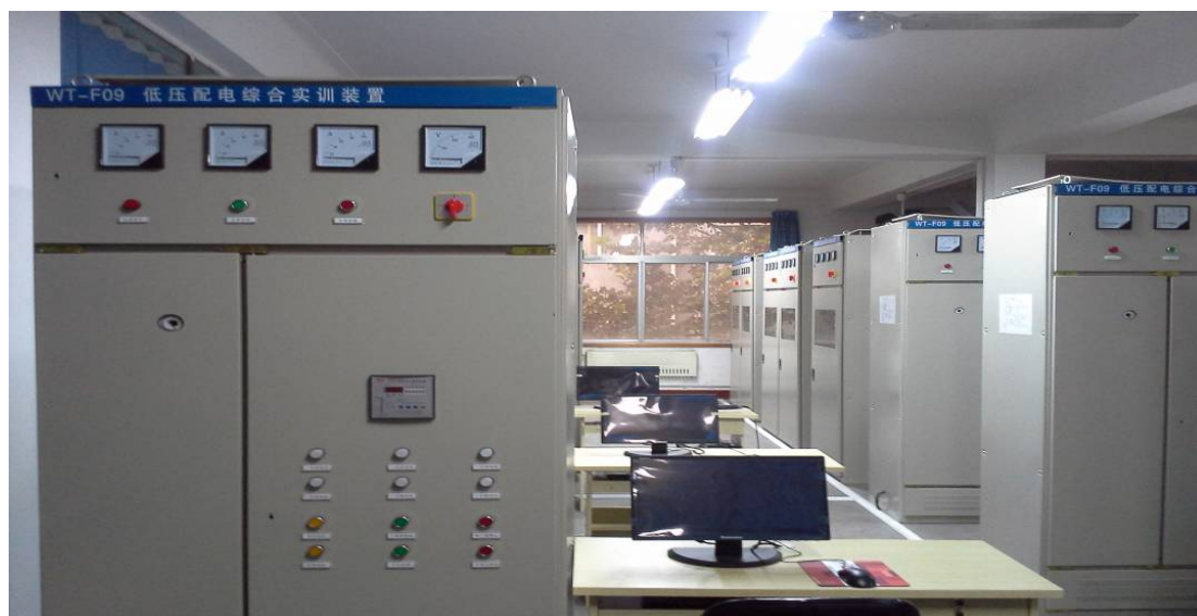
图 7 低压配电实训室
