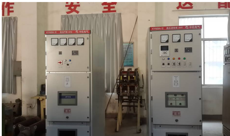
图 17 电气检修实训室 1
