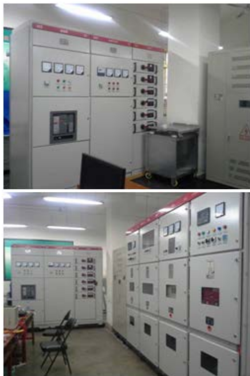
图 11 配网实训基地
