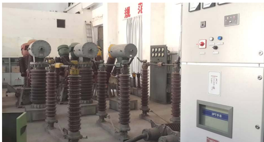
图 18 电气检修实训室 2
